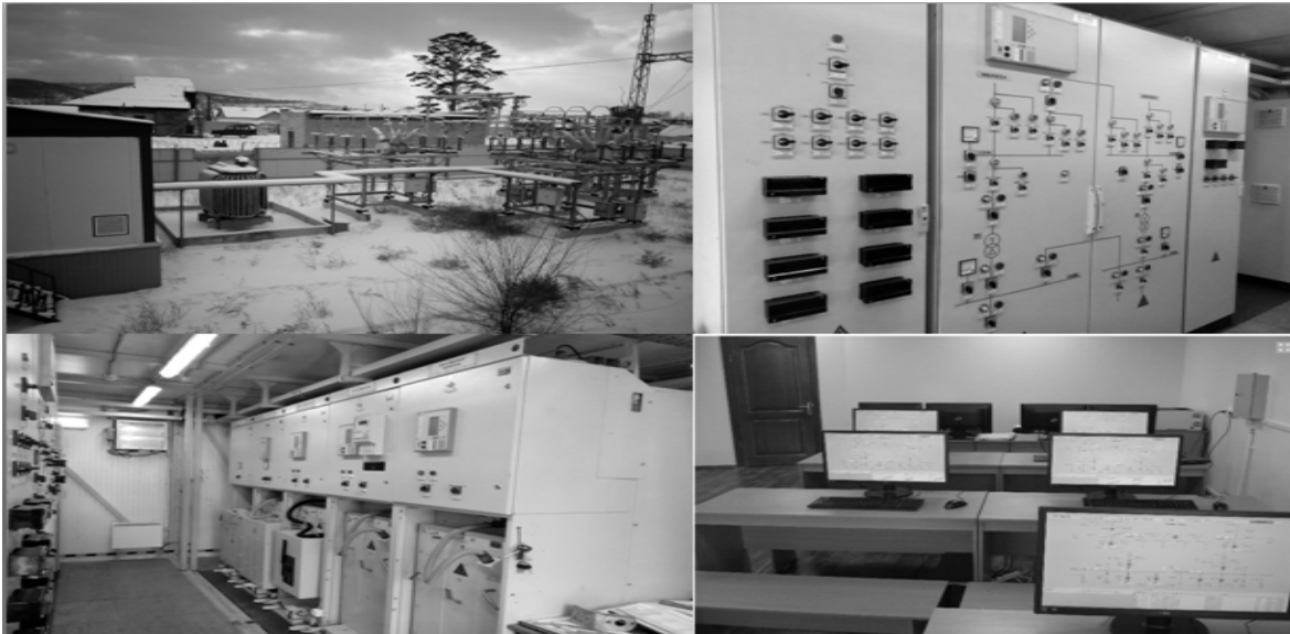
Рисунок. Учебная подстанция 35/10 кВ
